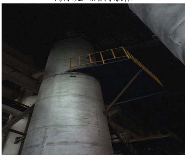
废气监测平台
